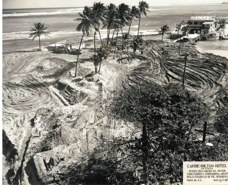
Figura 33. Área de construcción del Hotel Caribe Hilton el 24 de noviembre de 1947. Foto No. 13. Se puede observar en el segundo plano el Fuerte de San Gerónimo. Fundación Luis Muñoz Marín. Archivo Histórico, Compañía de Fomento Industrial de Puerto Rico.
