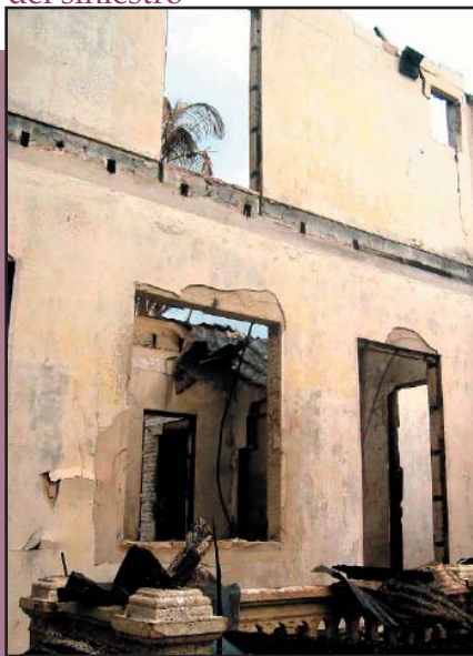
patio interior y galería después del siniestro
