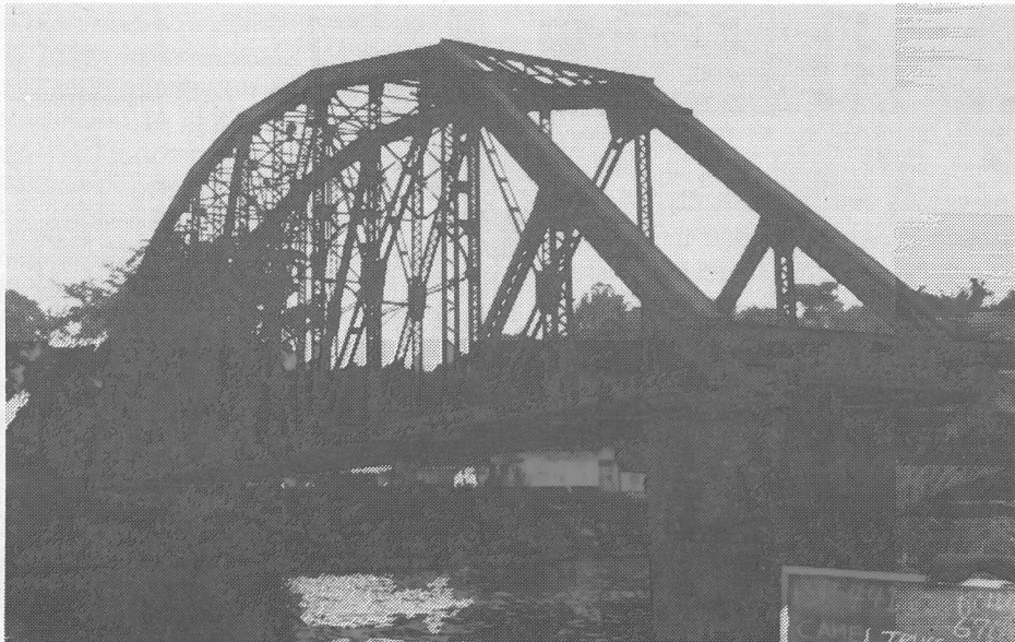
Puente de hierro, localizado sobre el río Grande de Loíza, en la carretera PR-8874 (Km. 0.1) de Canóvanas; constituye uno de los pocos testimonios remanentes de la arquitectura ferroviaria en Puerto Rico. Construido en 1900, será reemplazado dado su deterioro.
