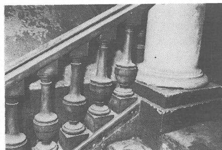
2. Detalle balaustres en ausubo escalera principal según existieron hasta 1985 antes de ser vandalizados
