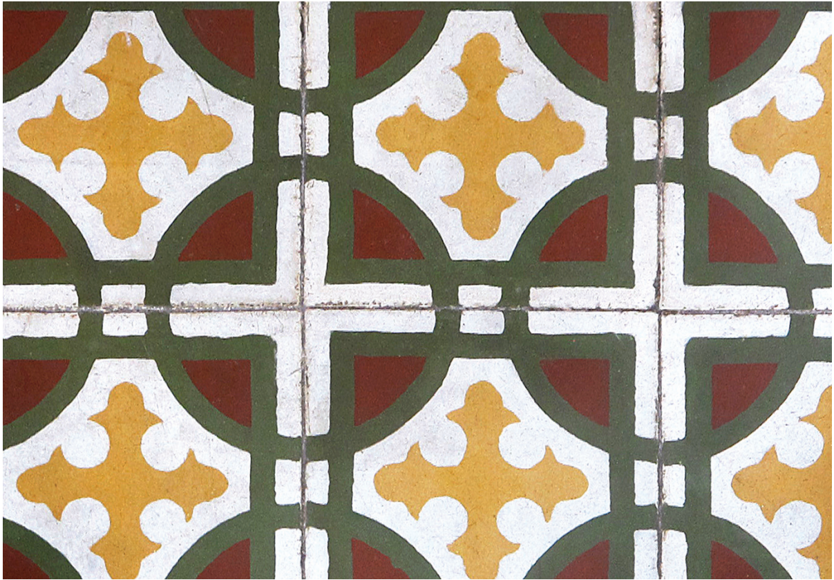
Detalle de losa en balcón de residencia en la urbanización Baldrich, calle Pintor Campeche, San Juan. Fotografía por Manuel Olmo Rodríguez.
