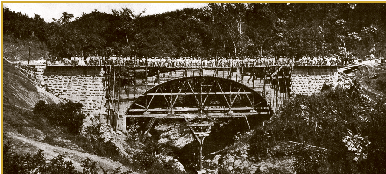
Puente Mavilla, Corozal, en proceso de construcción, c 1903, Informe del Comisionado del Interior 1903.
