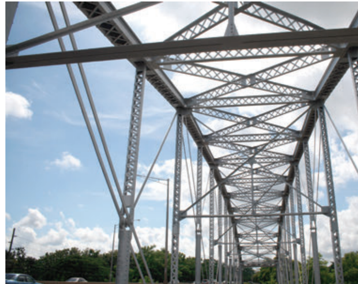
Puente de Añasco , vista de los elementos metálicos diagonales y verticales de la superestructura, 2010, OECH.
