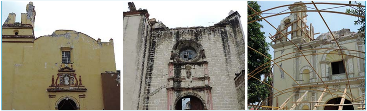
Daños en fachadas: (a) Jiutepec, Morelos; (b) Totolapan, Morelos, y (c) Pilcaya, Puebla. (Fotos: Marcos M. Chávez Cano)
