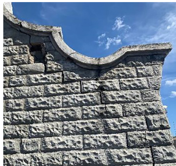
Pared agrietada en una de las fachadas de la iglesia. (Foto: José R. Gayá Gil)
