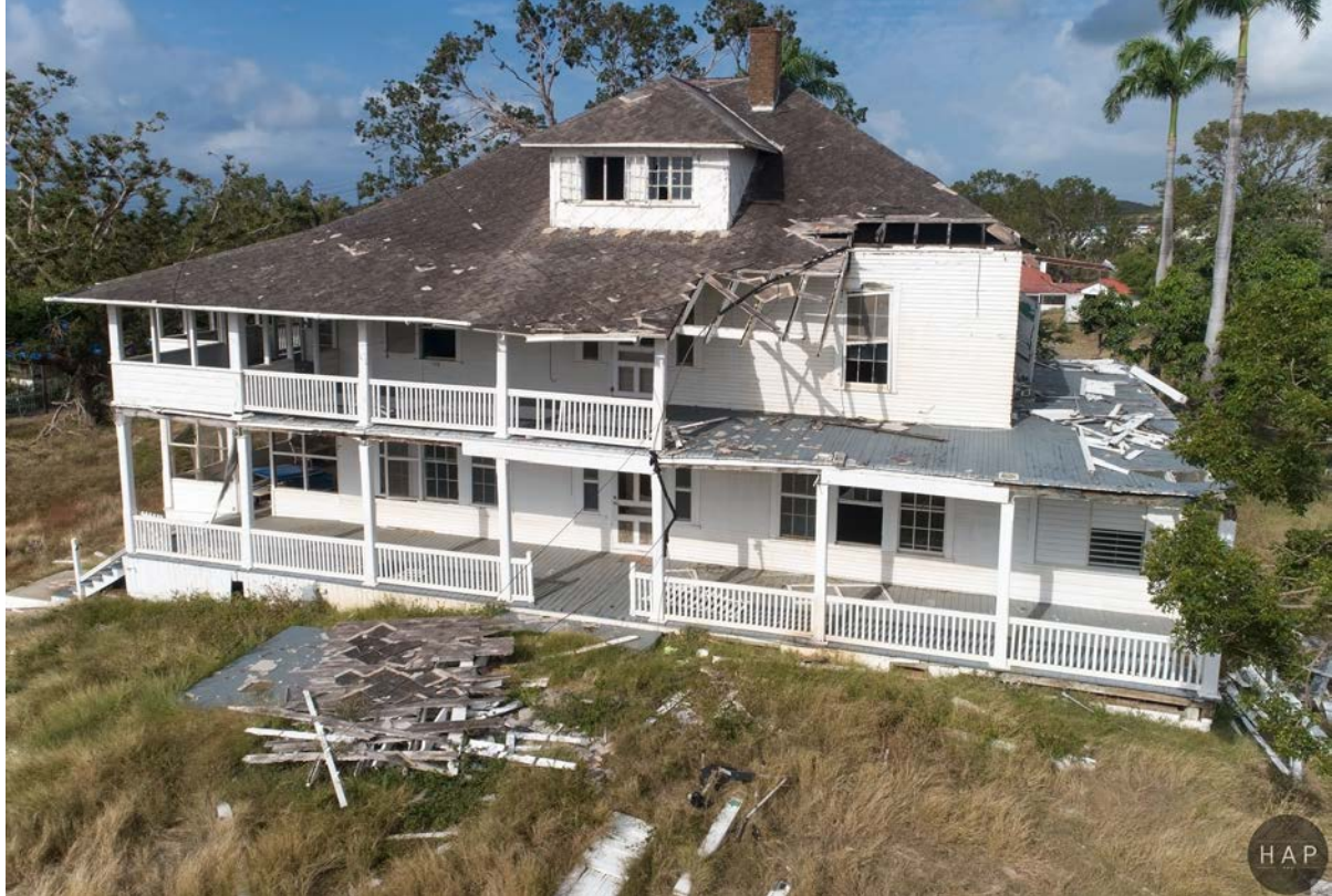
El distrito histórico de la Central Aguirre en Guayama sufrió graves daños por el Huracán María y varias de las propiedades están aún en riesgo. El distrito fue incluido en el World Monuments Watch 2020 para llamar la atención sobre la difícil situación que atraviesan las estructuras históricas de madera en Puerto Rico y sus comunidades tras el paso del huracán María. (Foto: Guillermo Ortiz Palacios, Proyectos de Archivos Históricos, 23 de marzo de 2018)
