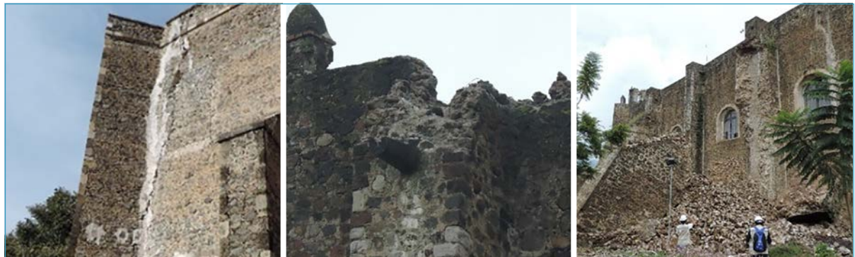
Daños en contrafuertes de templos del estado de Morelos: (a) Zacualpan; (b) Yecapixtla, y (c) Tlayacapan. (Fotos: Marcos M. Chávez Cano)
