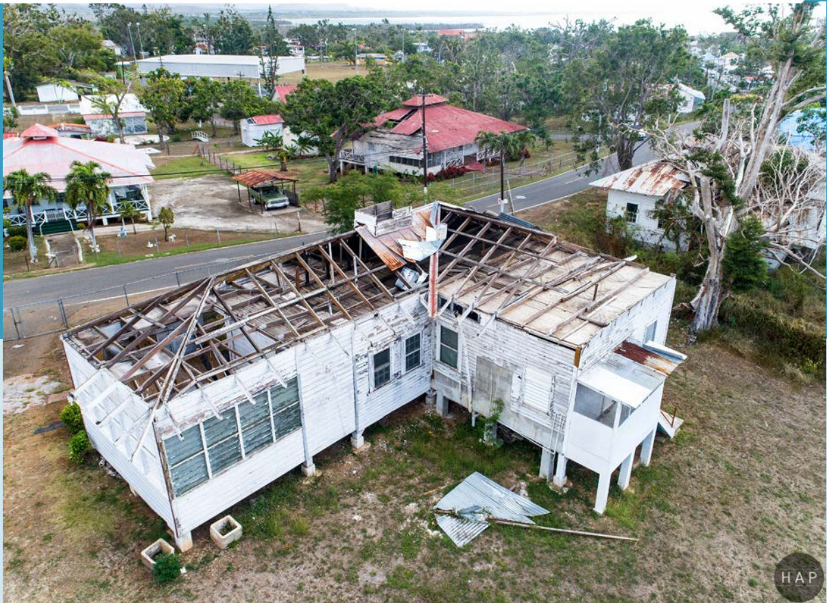
Vivienda de madera afectada por el paso del huracán María en el Distrito Histórico Central Aguirre. (Fuente: Jaqueline Hayden y Guillermo Ortiz Palacios –conductor de dron–, Historic Archive Project)
