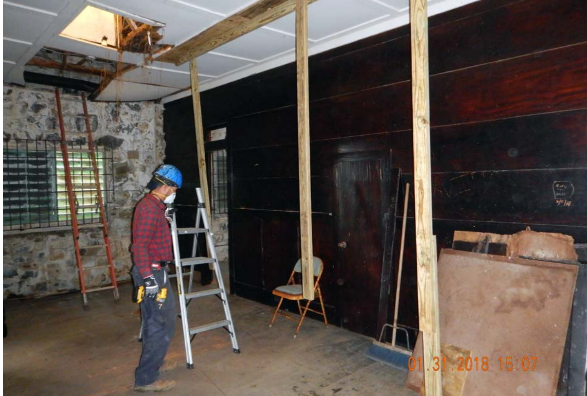
Brigadas de emergencia trabajando en la estabilización del interior de la Casa de Piedra. (Fuente: Raymond Feliciano, Servicio Forestal)
