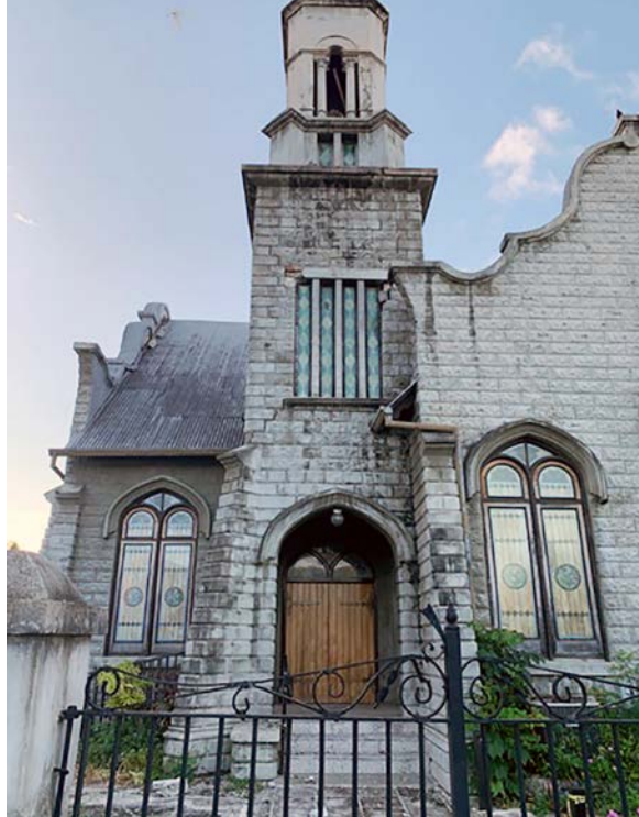
El campanario de la iglesia, ubicado en la entrada, presenta grietas en sus paredes. (Foto: José R. Gayá Gil)
