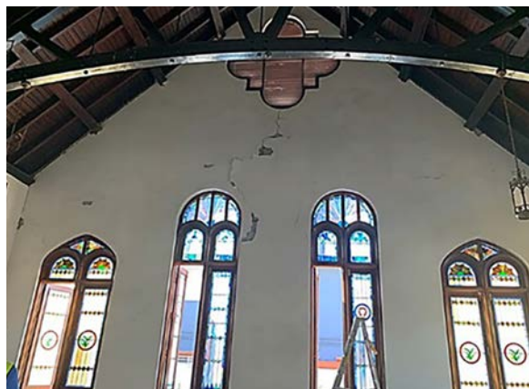
Vista interior de una de las paredes perimetrales agrietadas. (Foto: José R. Gayá Gil)
