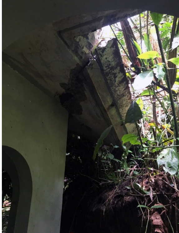
Daños en una de las cabañas históricas. (Fuente: Raymond Feliciano, Servicio Forestal)
