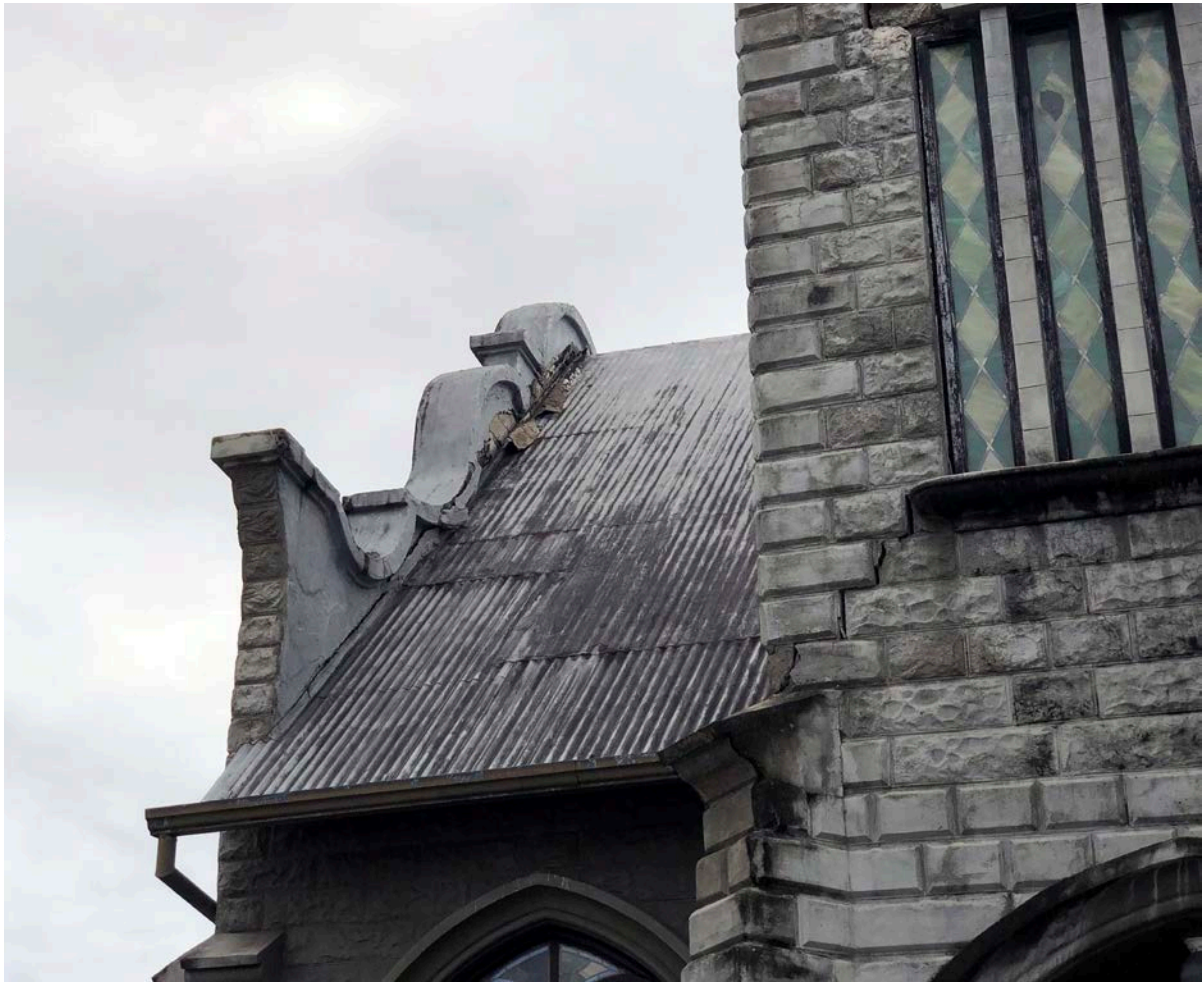
Separación de techo y pared. (Foto: Oficina Estatal de Conservación Histórica).
