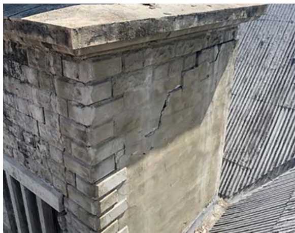
Vista lateral del campanario con una de sus grietas a través de los bloques. (Foto: José R. Gayá Gil)
