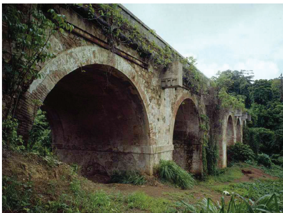
Puente Norzagaray de la Carretera Central, en el actual tramo PR-873. Esta estructura de 120 metros de longitud en ocho grandes arcos de ladrillo sobre la quebrada Frailes se completó en 1855. Se rehabilitó en 1930 tratando de afectar la fachada lo menos posible, y hoy sigue en uso tras la conversión a expreso de casi toda la carretera entre Río Piedras y Caguas.
