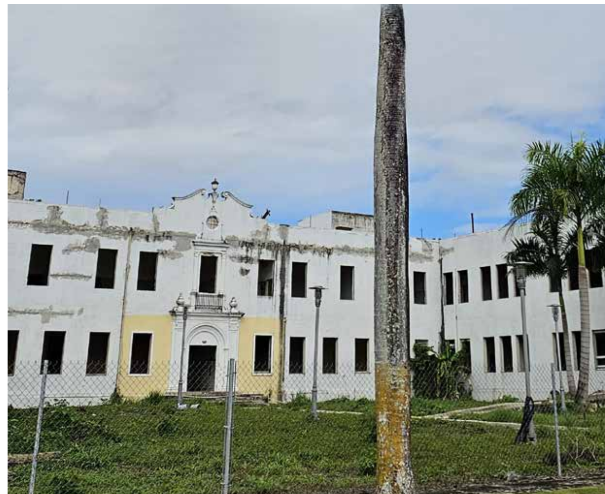
Fotografía tomada en febrero de 2024 que evidencia el estado actual de deterioro del Antiguo Hospital de Distrito de Bayamón, que en 1960 se convirtiera en el Hospital de Tuberculosos Dr. Alejandro Ruiz Soler. Fuente: Fotografía tomada el 13 de febrero de 2024, por el autor.
