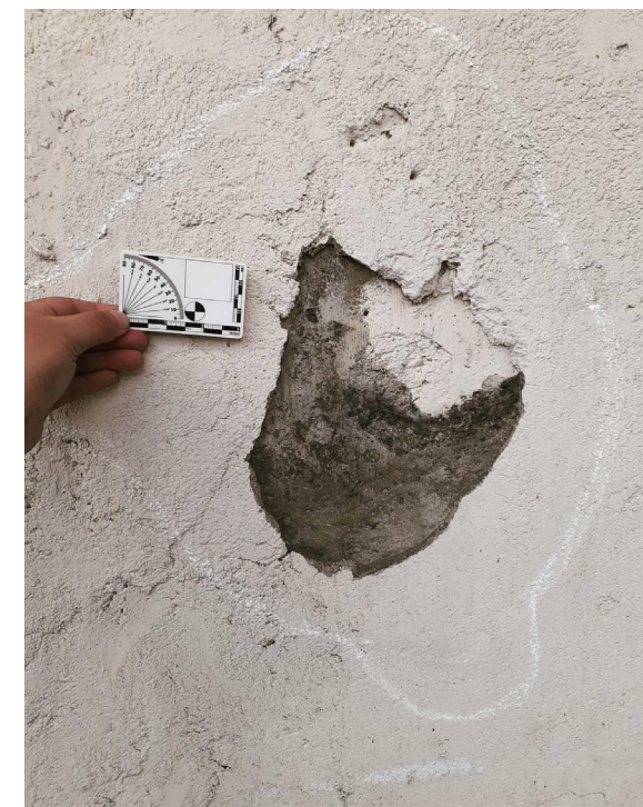
Estado de los empañetados de cemento en pared del lado sureste de la iglesia. Fuente: Héctor Berdecia Hernández, 2020.
