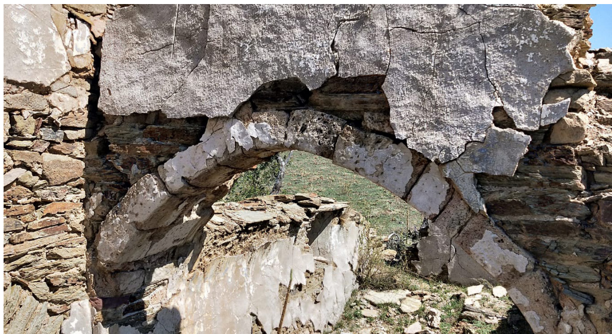
Iglesia de Sant Jaume de Llirt, Pirineos de Lleida. El deterioro de una pintura mural que no está protegida es muy rápido, hasta su pérdida total. Fuente: Pere Rovira.
