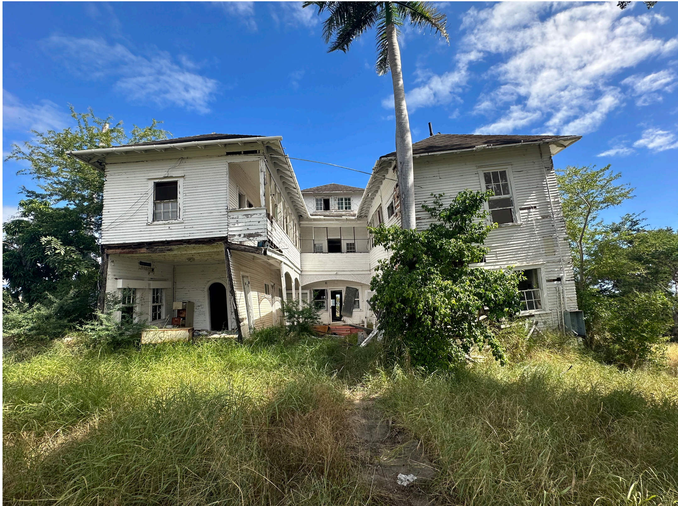
La fachada trasera de la Casa Grande del Distrito Histórico de Central Aguirre en enero de 2024, que demuestra condiciones de deterioro y abandono tras los huracanes de 2017. Fuente: Andrés D. Santana Miranda.
