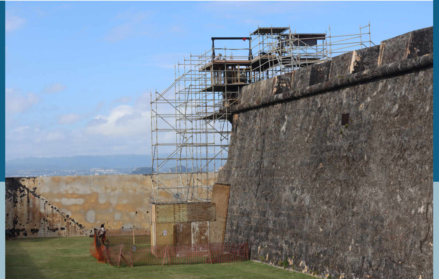
Vista de andamio como parte del proyecto de restauración de una garita impactada por un rayo en el Bastión de Austria, Castillo San Felipe del Morro, 2025. Fuente: NPS.
