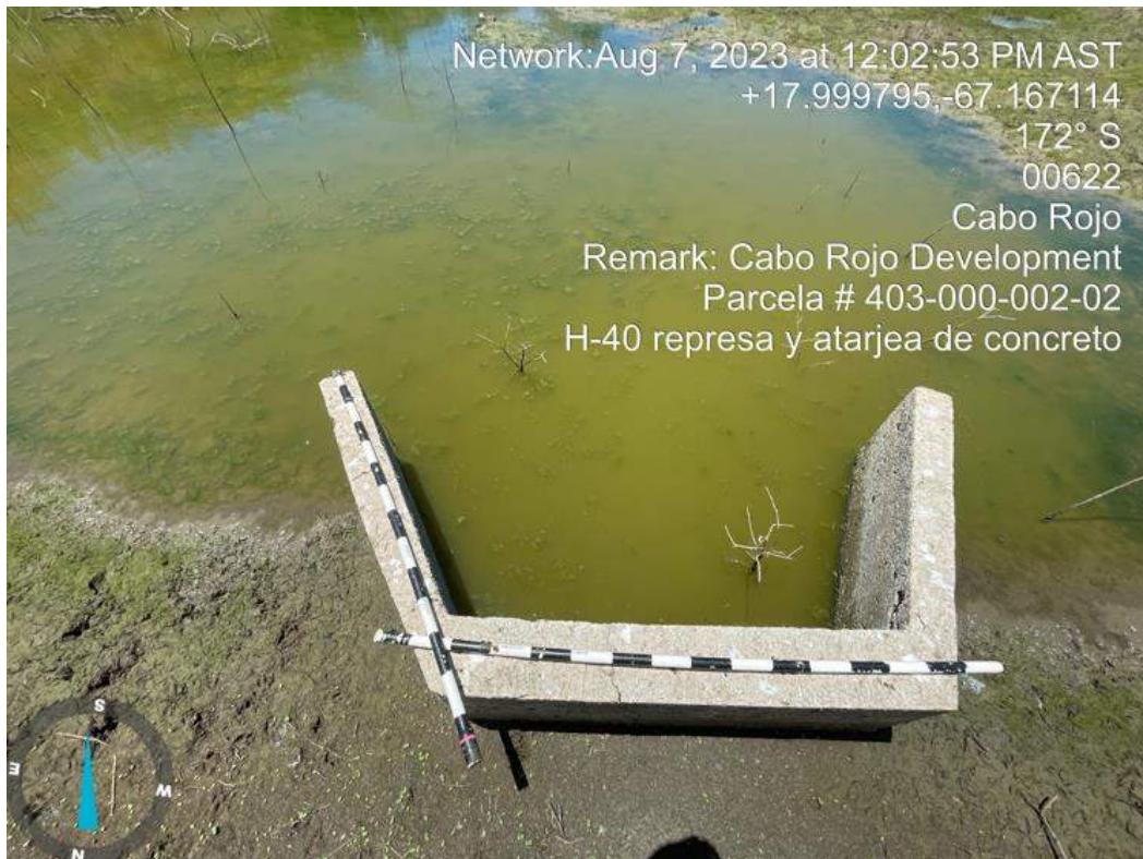
Foto 103. Elemento H-40. Represa y atarjea de concreto.
