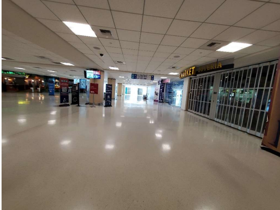
Ilustración 8: “Replace Deteriorating Flooring” – Pasillo entre Terminal “A” y “B”.
