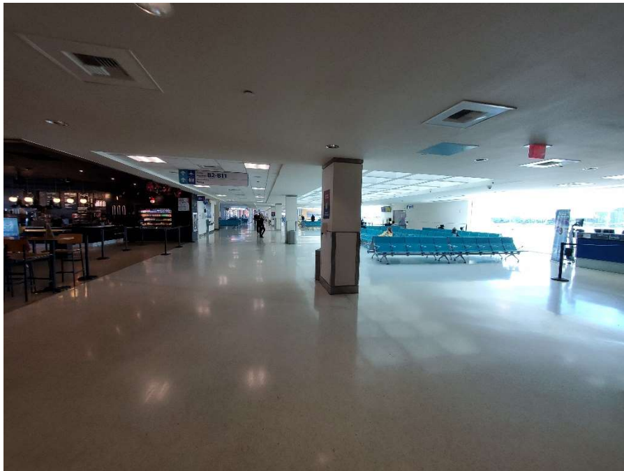
Ilustración 9: “Replace Deteriorating Flooring” Terminal “B”
