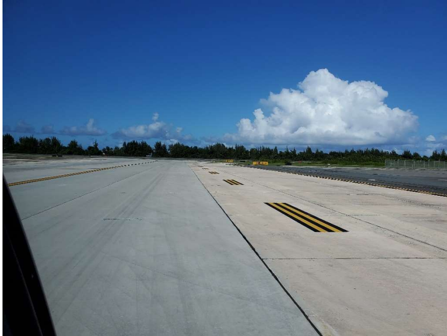
Ilustración 7: Vista de Taxiway “N” hacia Taxiway “S”.
