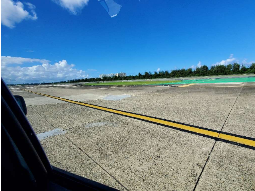
Ilustración 15: Intersección entre Taxiway "N" y Taxiway "S" – reparación de superficie en concreto
