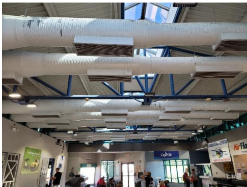
Vista del sistema central de extractores de aire (parte superior) que fue remplazado por unidades de acondicionador de aire.
