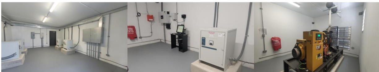
Algunos de los nuevos equipos del Sistema que alberga la bóveda de cemento.
